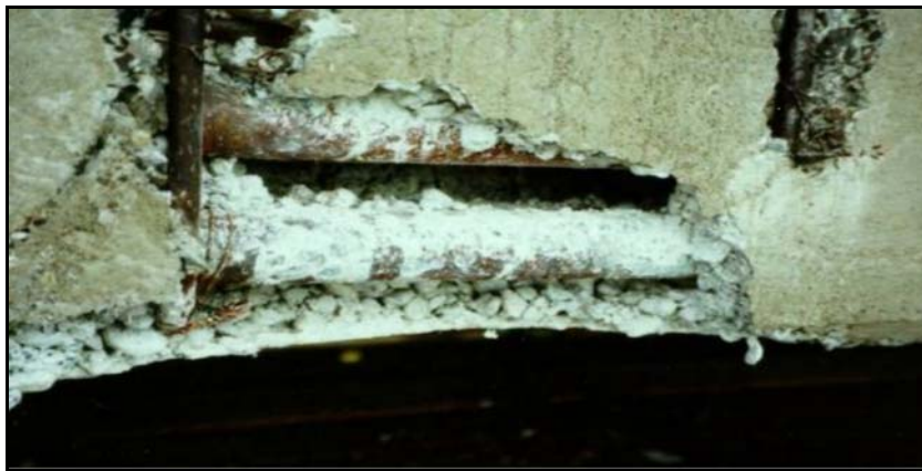
Fig.3 – Pont de Peney, défauts.
