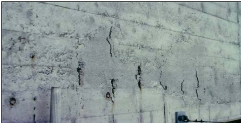
Fig.3 – Pont de Peney, défauts.
